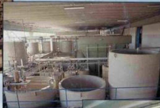
Estações para Tratamento de Efluentes
