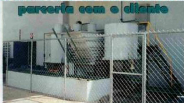
E.T.E instalada na ATLAS COPCO BRASIL LTDA.
