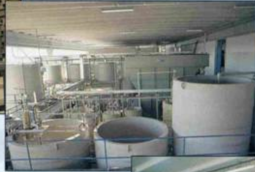
Estações para Tratamento de Efluentes
