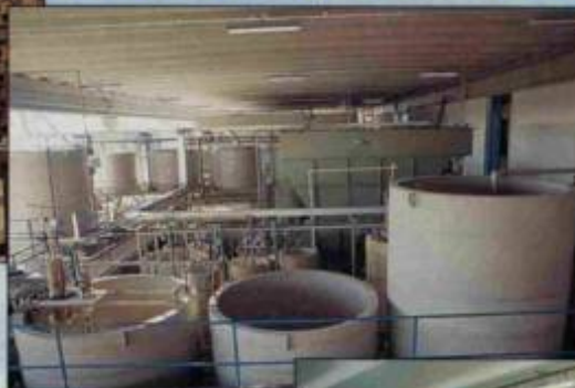
Estações para Tratamento de Efluentes
