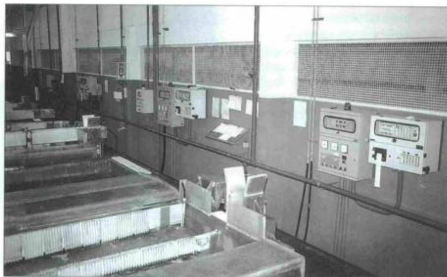
Uma instalação computadorizada de anodização
