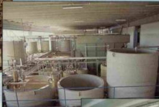
Estações para Tratamento de Efluentes
