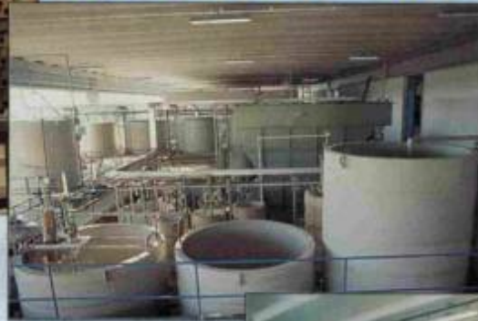
Estações para Tratamento de Efluentes
