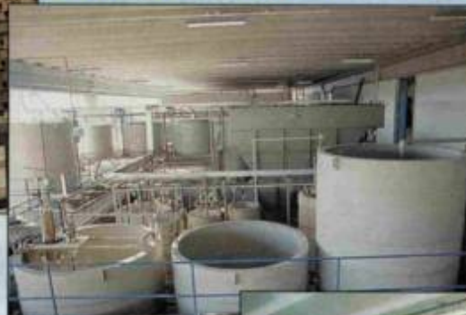
Estações para Tratamento de Efluentes
