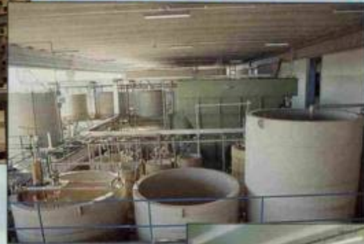
Estações para Tratamento de Efluentes
