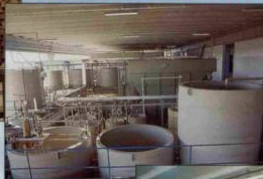
Estações para Tratamento de Efluentes
