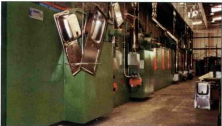
Equipamento de lavagem com transportador aéreo.
