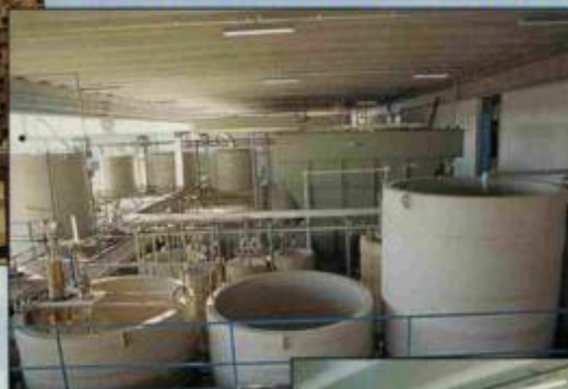
Estações para Tratamento de Efluentes
