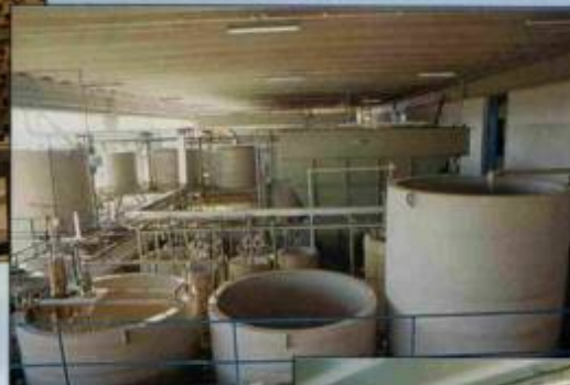
Estações para Tratamento de Efluentes
