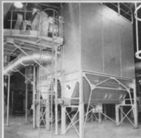
Sistemas de exaustão e captação de particuladas
