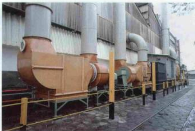
Lavadores de gases
