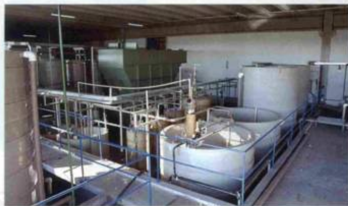
Estação de tratamento de efluentes
