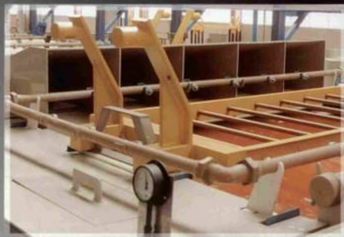
Exaustão tipo "push-pull"
