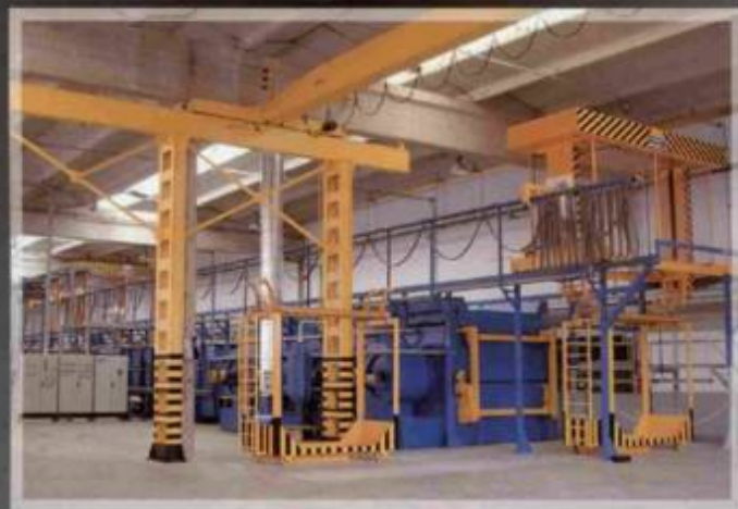
Transportadores enclausurados e com sistema de nebulização
