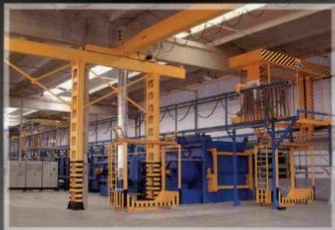
Transportadores enclausurados e com sistema de nebulização
