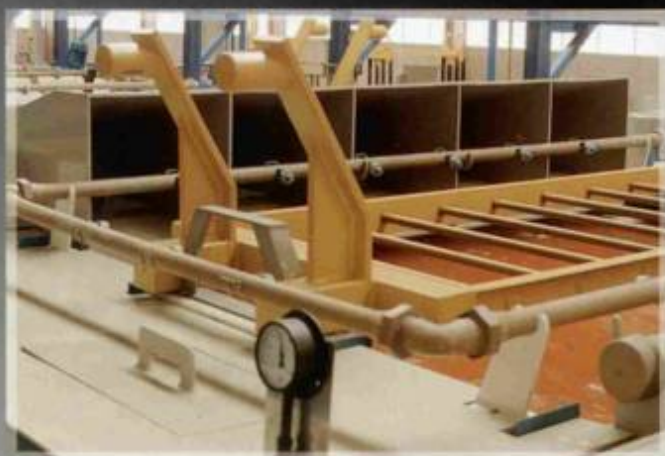
Exaustão tipo "push-pull"
