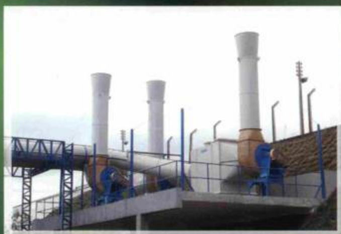
Exaustão com lavadores de gases
