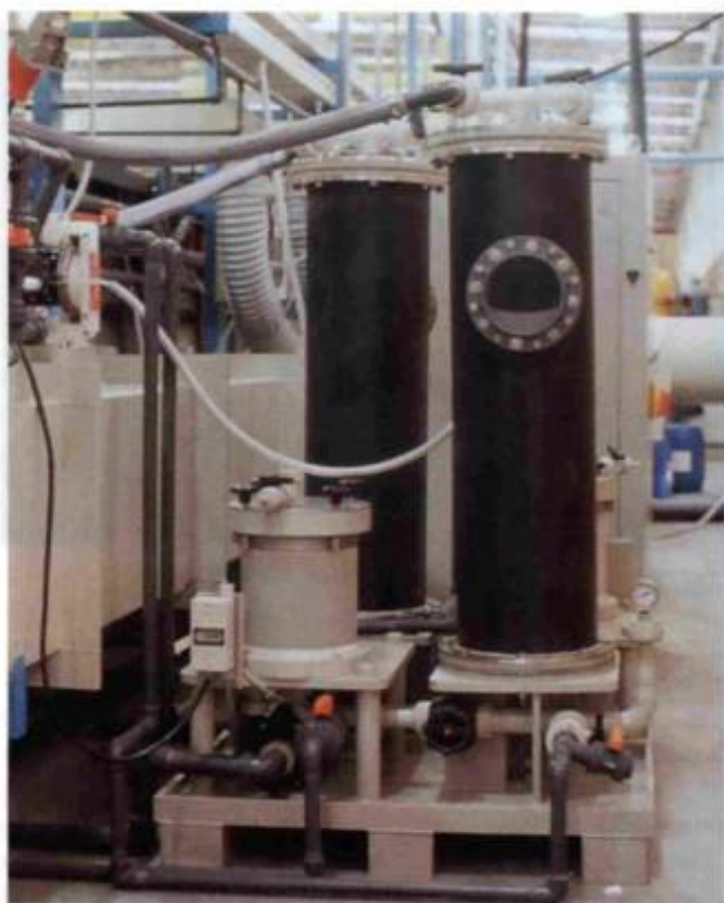
Coluna de resina trocadora de íons instalada na Metalúrgica MOR-RS
