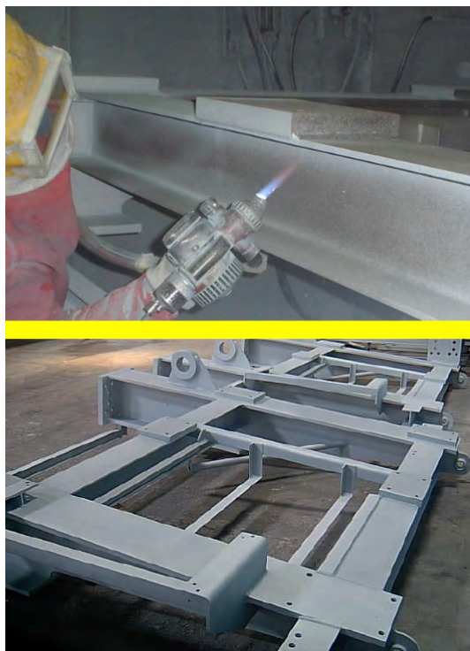
Foto 5 - Metalização em estrutura metálica eólica [Ref.: 10.q] / Foto 6 - Estruturas metálicas eólicas metalizadas [ Ref.: 10.q]
