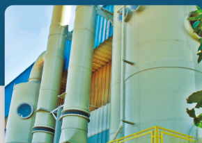
Sistemas de Exaustão
