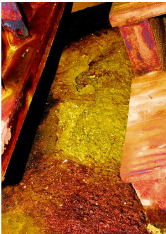
Foto 1 - Evidência de contaminação por permeação de solo com cromo em instalação galvânica.
