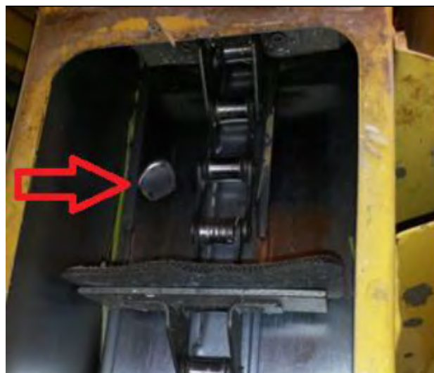
Foto 9 - Desgaste no elevador de grãos [Ref. 7.m]
