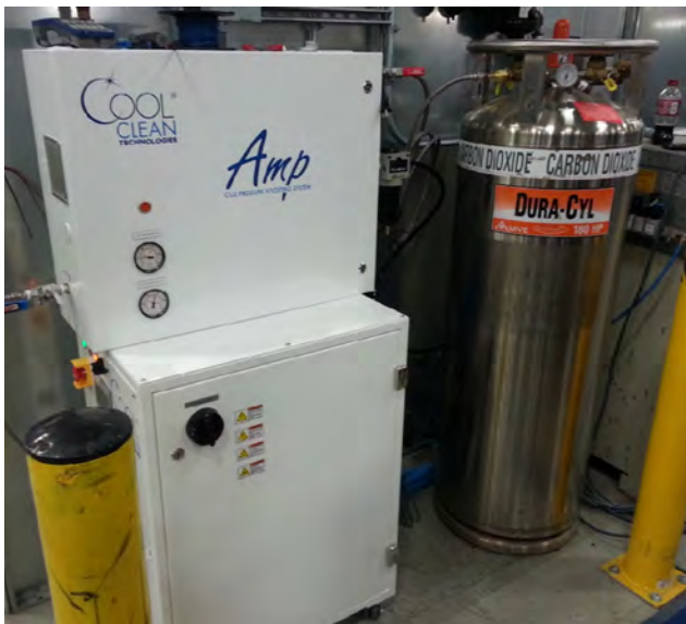
Requisitos de limpeza de CO 2 em uma instalação
