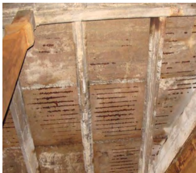
Figuras 10 e 11: Corrosão dos vergalhões na laje de concreto de reservatório de tratamento de água.
