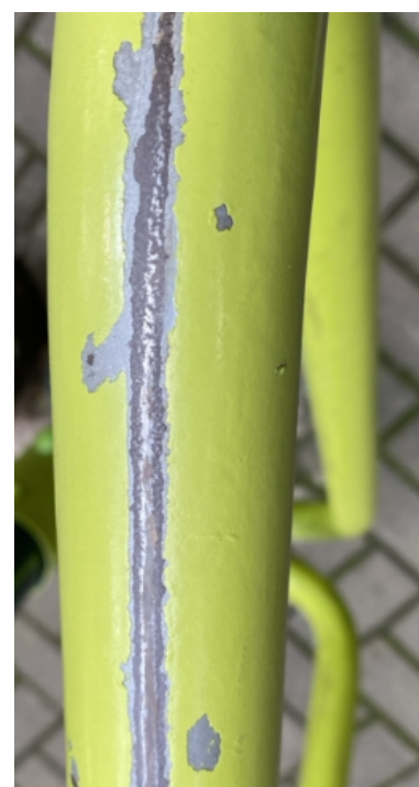
Figura 2, A e B (real): Proteção catódica sob a tinta
