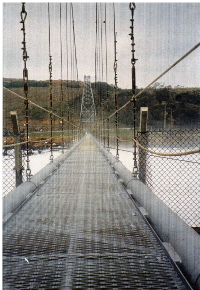
Foto 3 - Ponte para abatimento de espuma ácida no Rio Pirapora do Bom Jesus em Santana do Parnaíba, metalizada com zinco
