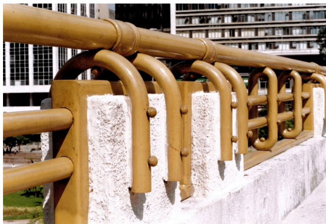
Foto 1 - Gradil do Viaduto do Chá-Centro de São Paulo/ SP: metalizado com zinco seguido de bronze
