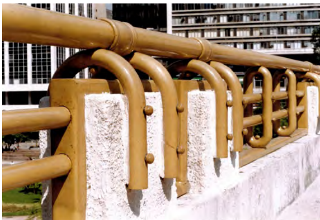
Foto 1 - Gradil do Viaduto do Chá-Centro de São Paulo/ SP: metalizado com zinco seguido de bronze
