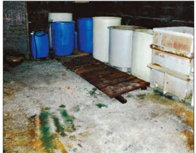
Figura 1 – Indícios de contaminação na área de niquelação em piso sem impermeabilização.
