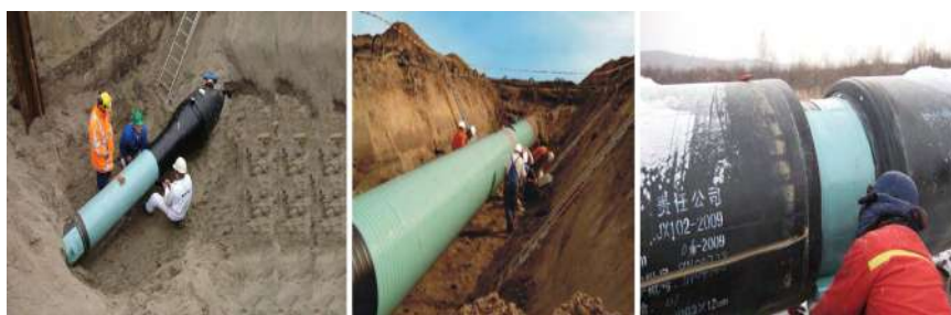
Figura 25. Sistemas de dutos enterrados revestidos ou reparados com revestimentos à base de PIB.
