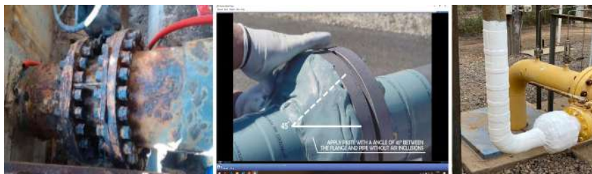
Figura 18. Revestimento de estruturas com geometrias irregulares e corrosão avançada.
