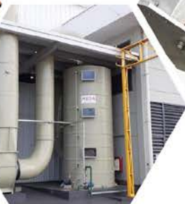
Lavador de Gases
