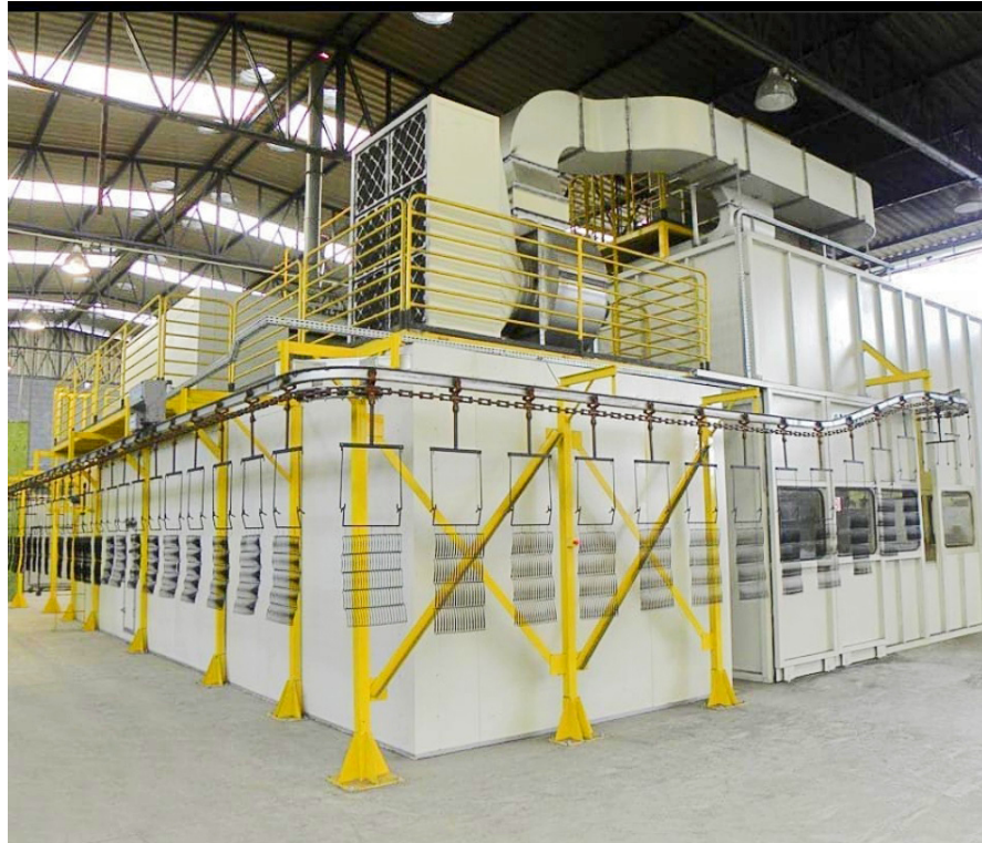
Mais instalações da Art Coating Pinturas Técnicas, onde Lucas Pinheiro atuou como KTL, pintura eletrostática a pó e adesivação metal e borracha
