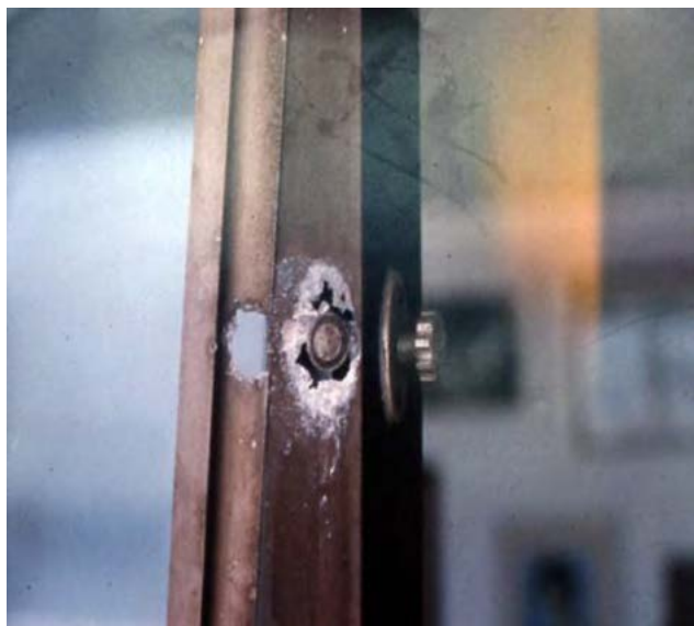
Figura B - Corrosão por diferença de potencial entre Al (alumínio) e Cu (cobre) 2,02 E0 (Volts)
