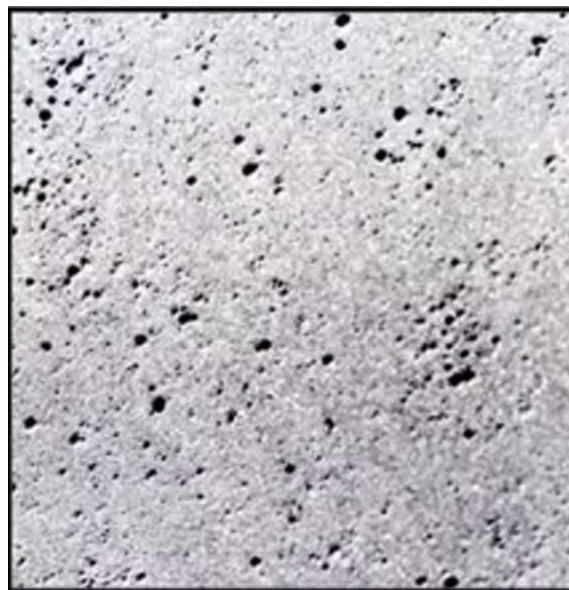
Figura 2 - Corrosão por pites
