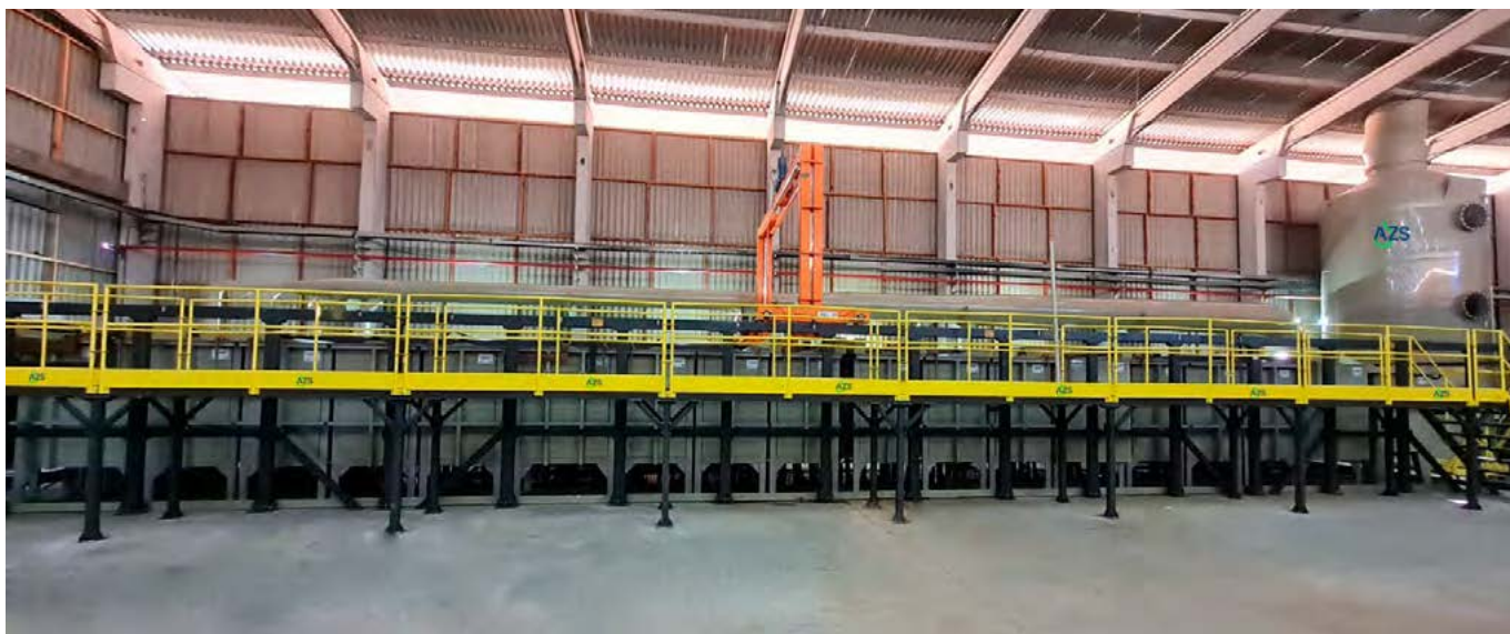
Linha para tratamento de superfícies com lavador de gases
