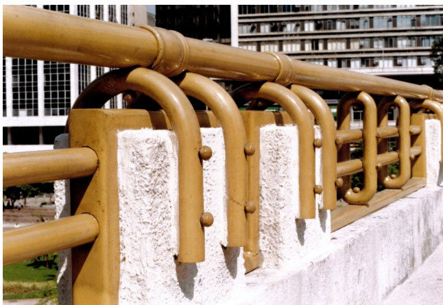
Foto 1 - Gradil do Viaduto do Chá-Centro de São Paulo/ SP: metalizado com zinco seguido de bronze
