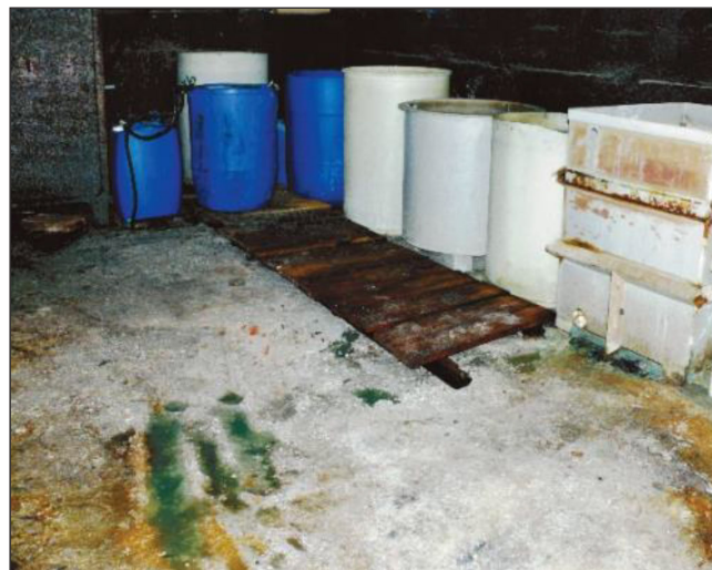
Figura 1 – Indícios de contaminação na área de niquelação em piso sem impermeabilização.
